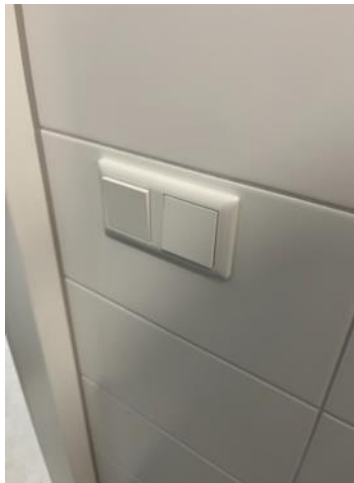
Voorbeeld van een puls schakelaar in de badkamer.
